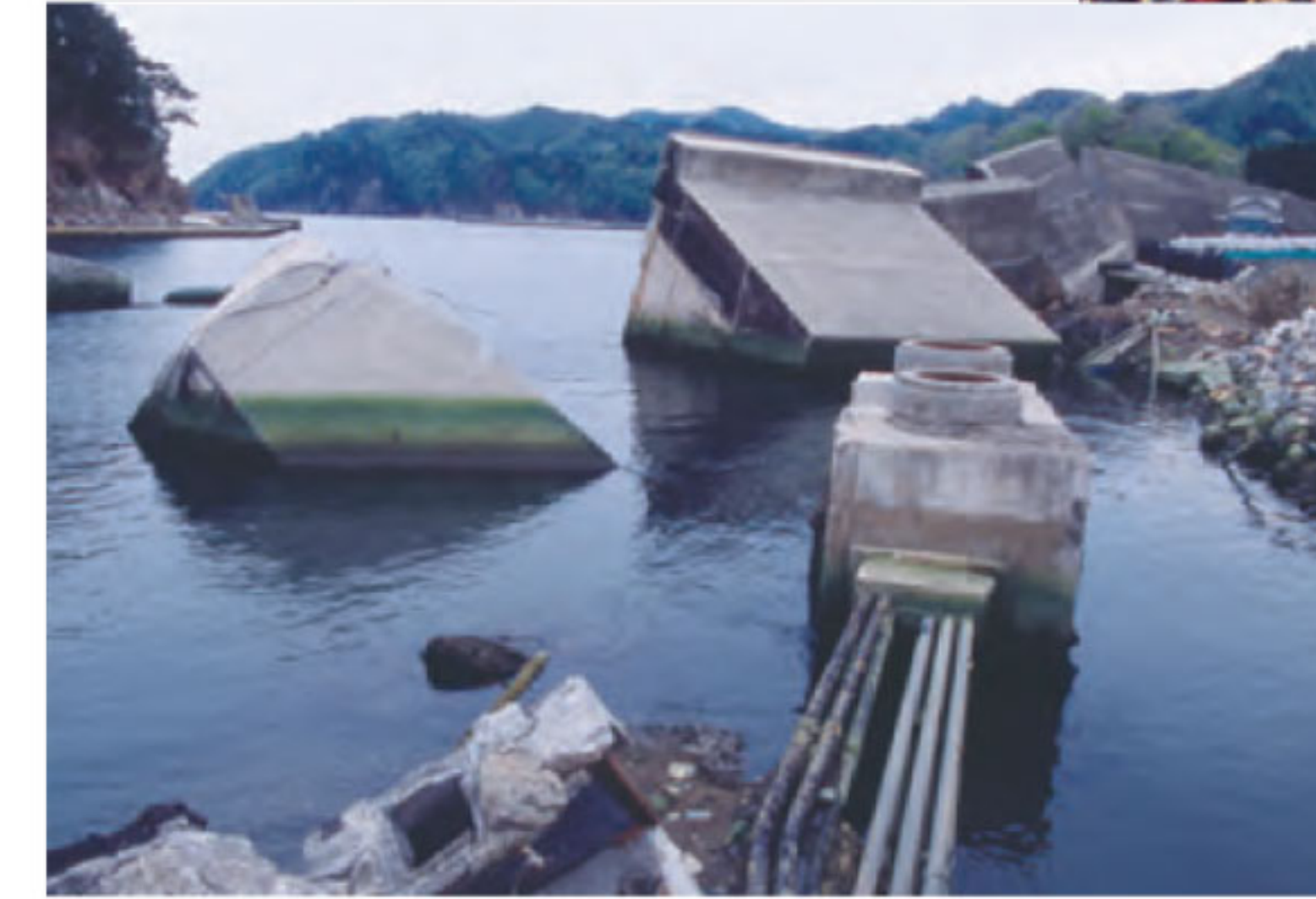
巨額の費用を投じてつくられた防潮堤は津波によって破壊されました
